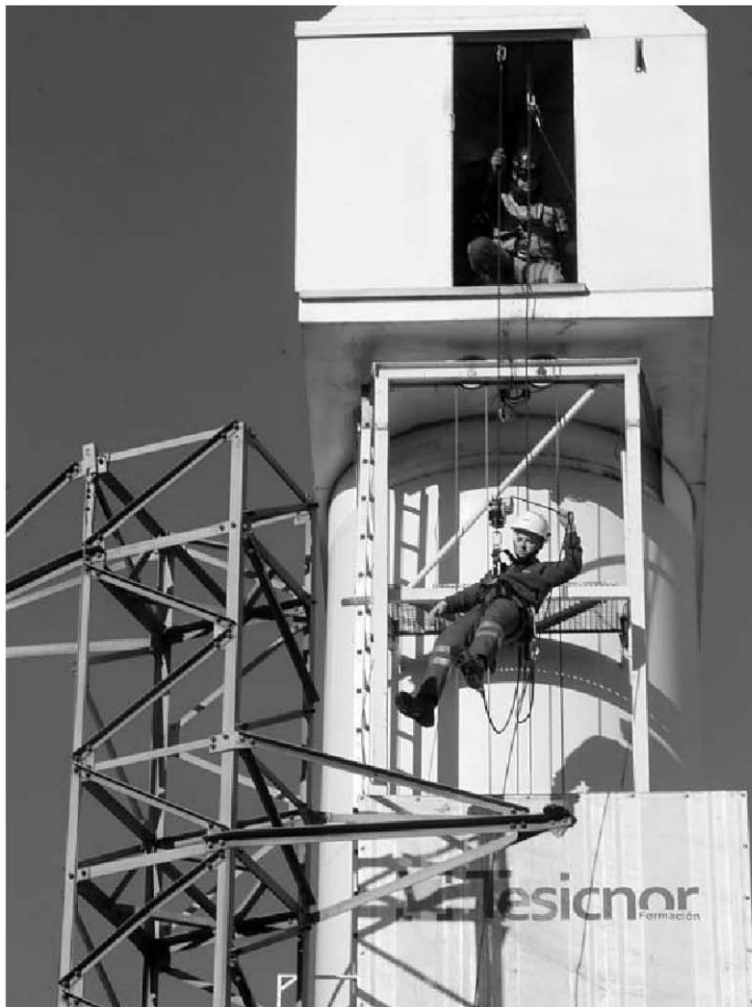
Siete operarios de parques de Iberdrola realizaron ayer en Noáin varias simulaciones de rescates en aerogeneradores con formadores de la empresa navarra Tescinor. JOSE CARLOS CORDOVILLA
